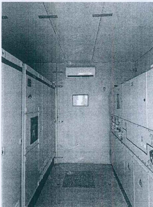
Slika 4. Izgled 10 kV postrojenja
