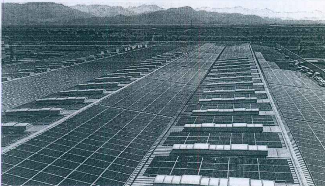
Slika 2. Izgled ugrađenih solarnih panela
